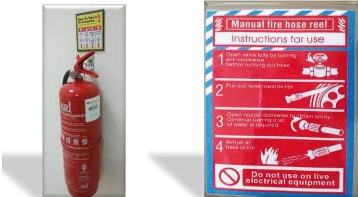
Peralatan Pencegahan Kebakaran
